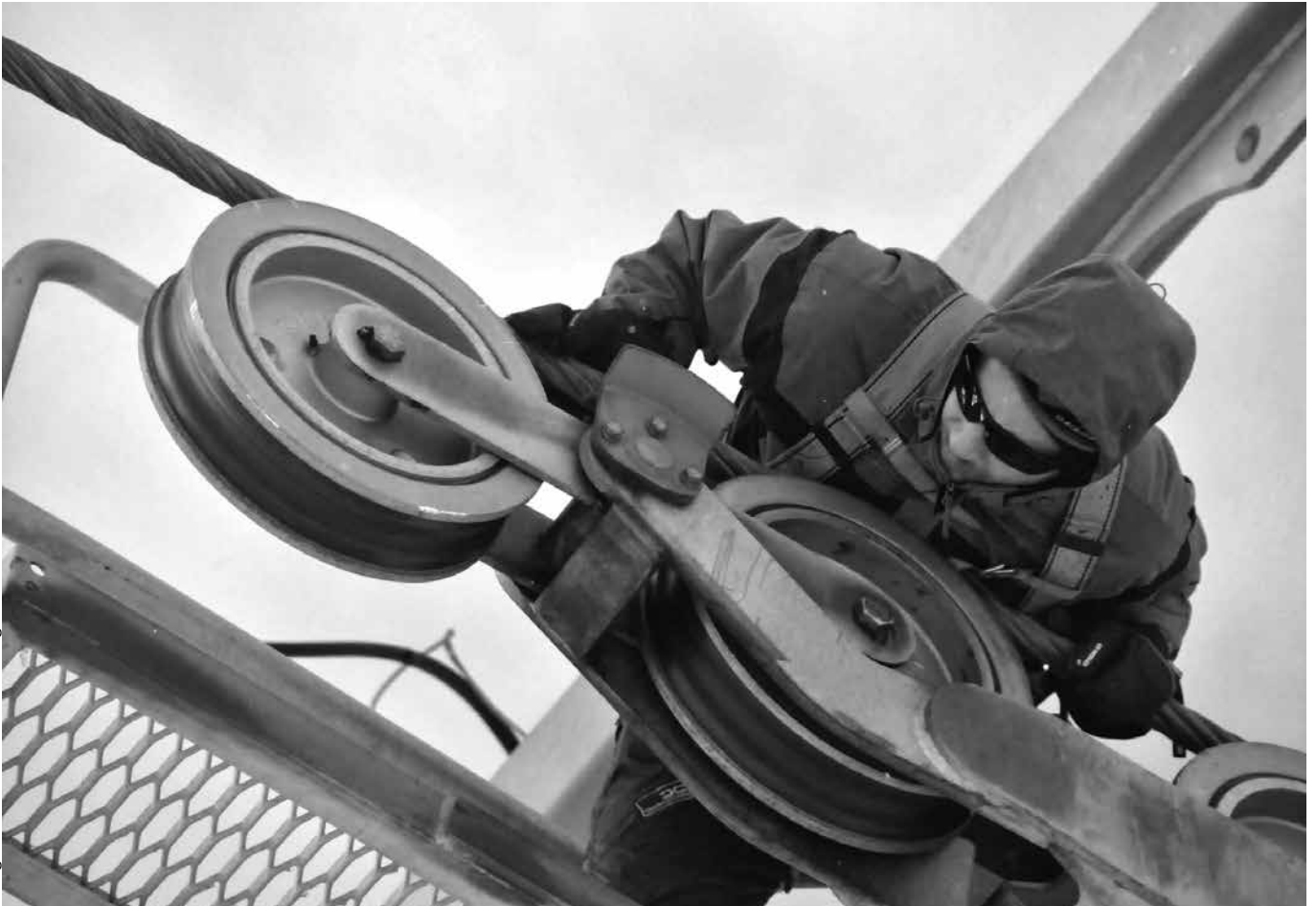
Inspeccionando una torre del Catedral, donde descarriló el cable hace un par de años.
